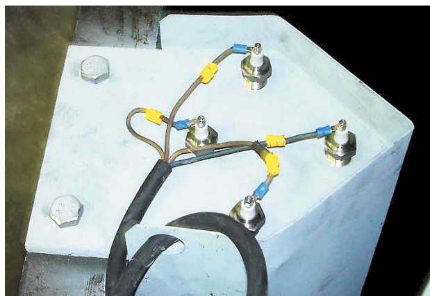
Кронштейн с датчиками уровня пульпы/ Shelf with pulp level sensors
